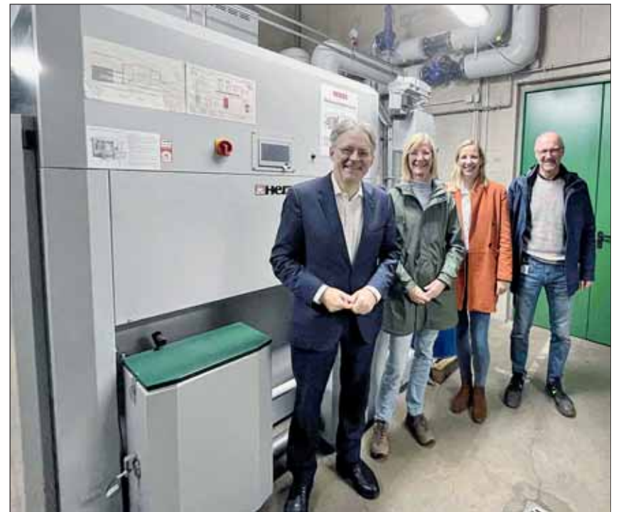
Stark und effizient: Achim Post, Anna Hermeier, Elisabeth Holland und Uwe Hempen-Hermeier besichtigen die neue, stärkere Hackschnitzelheizung bei Jenz mit einer Leistung von 540 kW. Fotos: Jenz
